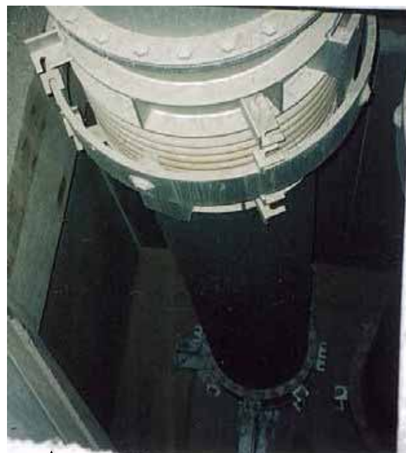
↑ 設置後の煙突免震継手
